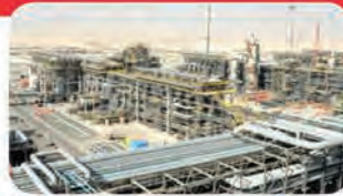
IGD Habshan - UAE
